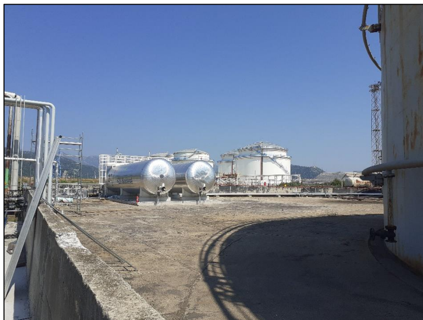
Slika 27. Spremnici aditiva za biodizel – NTF d.o.o. Ploče, Skladište za tekuće terete u Luci Ploče
