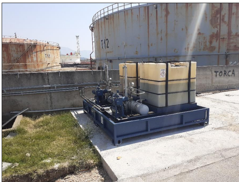
Slika 28. Spremnici aditiva za gorivo – NTF d.o.o. Ploče, Skladište za tekuće terete u Luci Ploče
